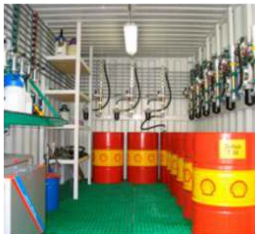
Magazzino oli in container misure fuori standard, piano di calpestio in grigliato di vetroresina 500kg mq
